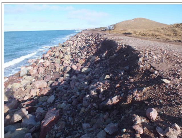
Zone d'effondrement aval
