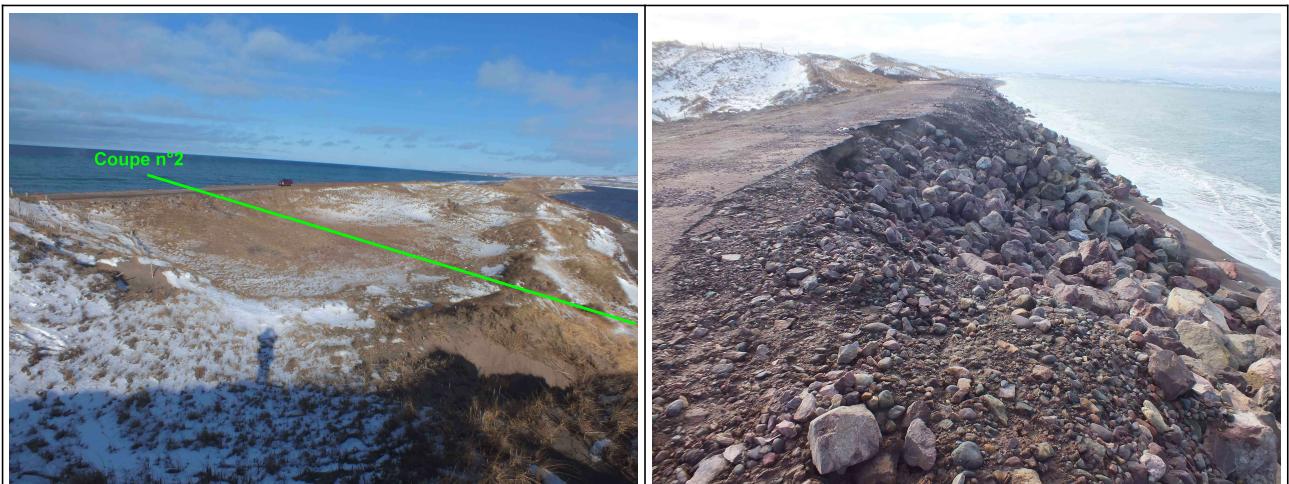
Zone d'effondrement digue amont
